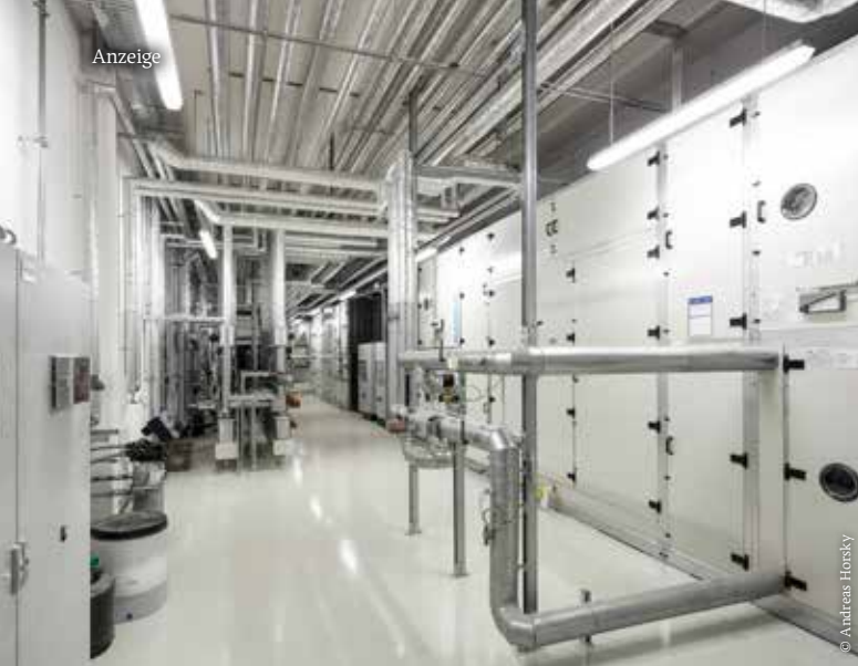
Blick in eine moderne Technikzentrale - Lufthygiene, Energieeffizienz, Adiabate Kühlung, beispw. umgesetzt in der LWL-Klinik Dortmund
